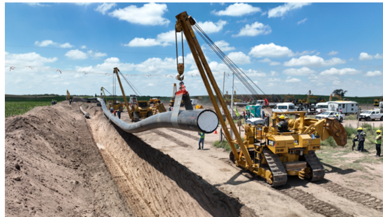
Gasoducto Perito Moreno (GPM).
